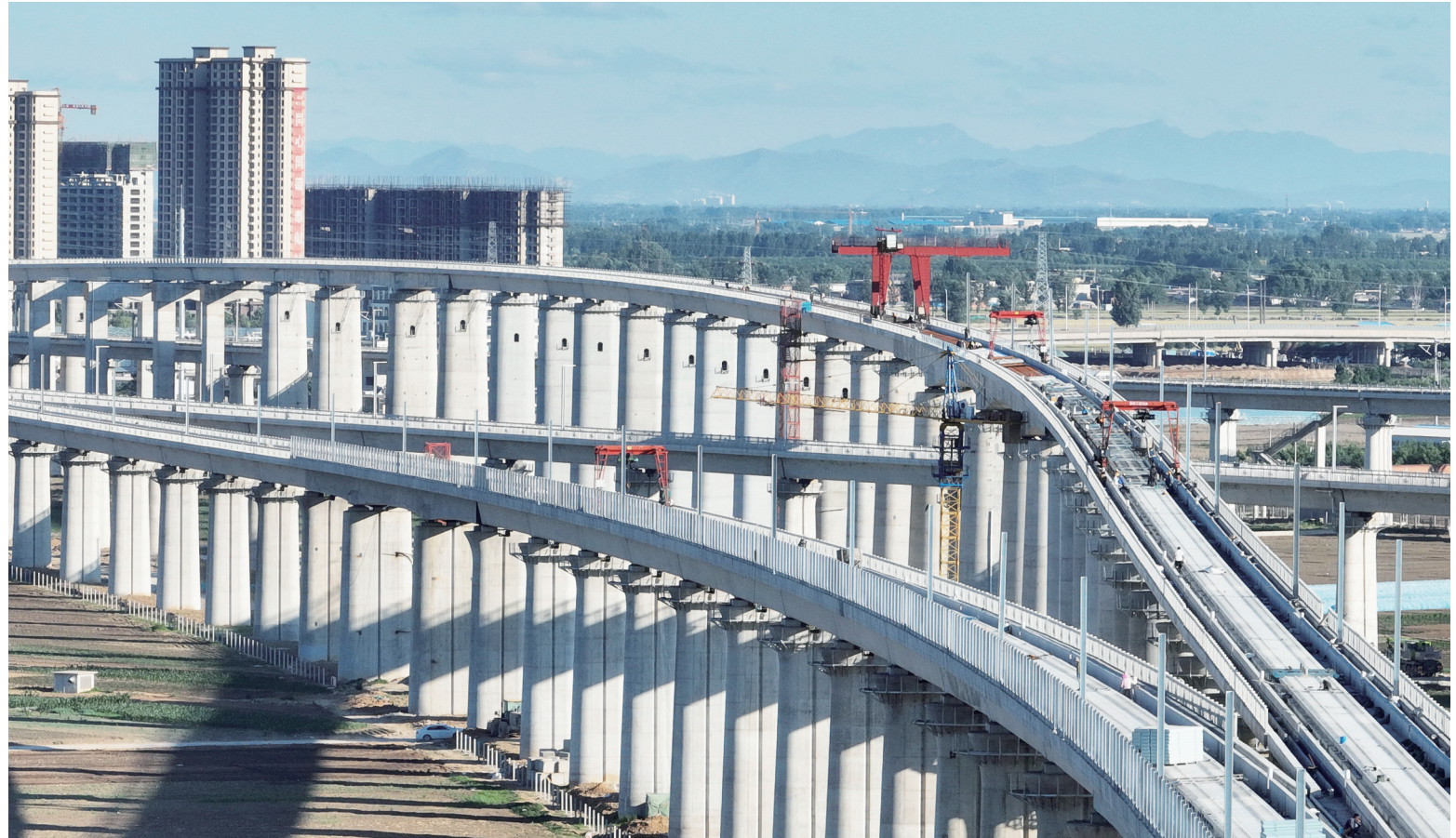
近日,京唐城际铁路建设正在按照节点要求扎实推进。京唐城际铁路是国家重点工程,也是京津冀城际轨道交通网络的重要组成部分,起自北京城市副中心站,终至河北省唐山市唐山站,正线线路全长148.7公里。图为工人在唐山市高新技术开发区境内的京唐城际铁路建设工地施工。新华社记者 杨世尧 摄
